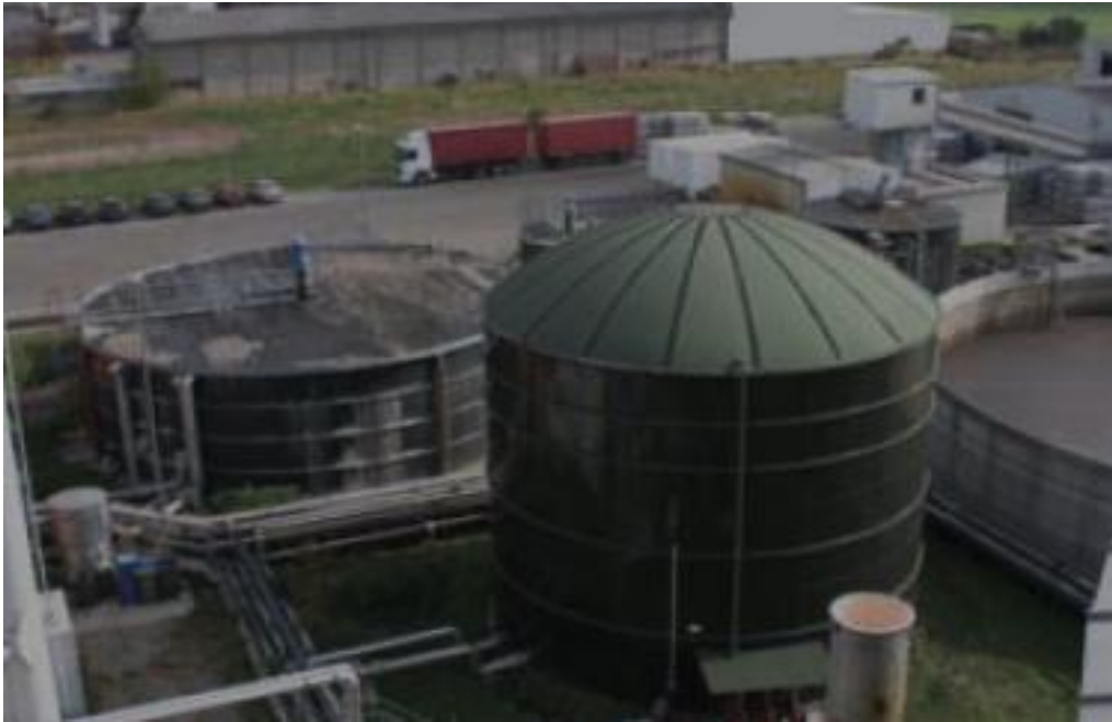
Figura 2.16 Digestor industrial en España
