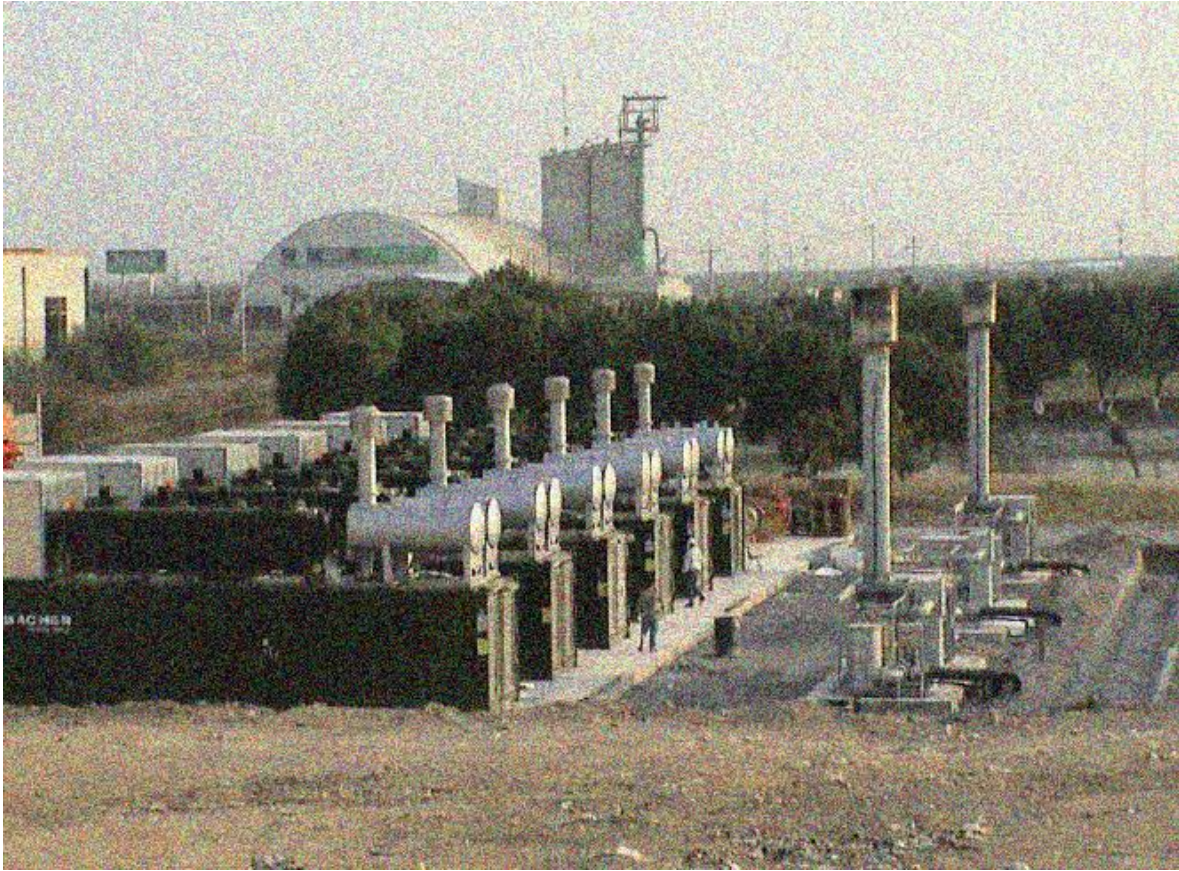
Figura 2.8 Central de biogás en relleno sanitario de Salinas Victoria
