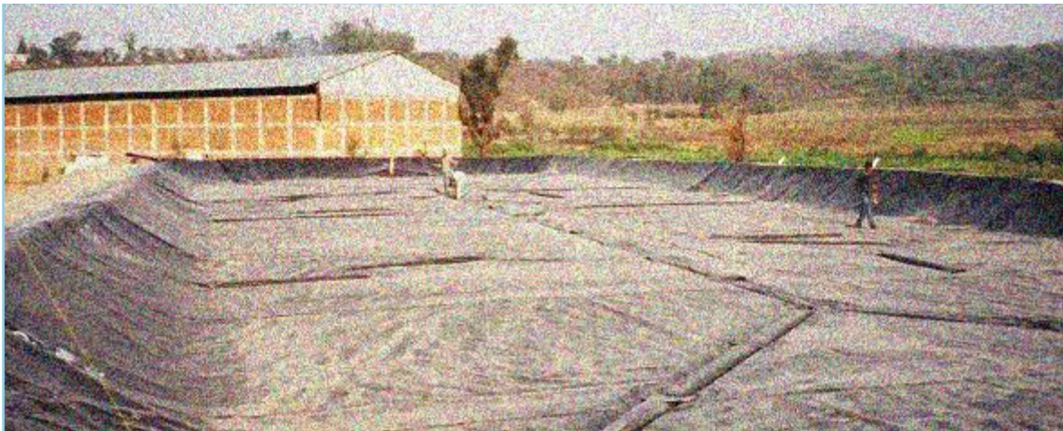
Figura 5.8 Cubierta de laguna con geomembrana de polietileno
