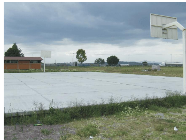
Canchas Multifuncionales en Tizayuca (muestran un deterioro y una falta de mantenimiento)
