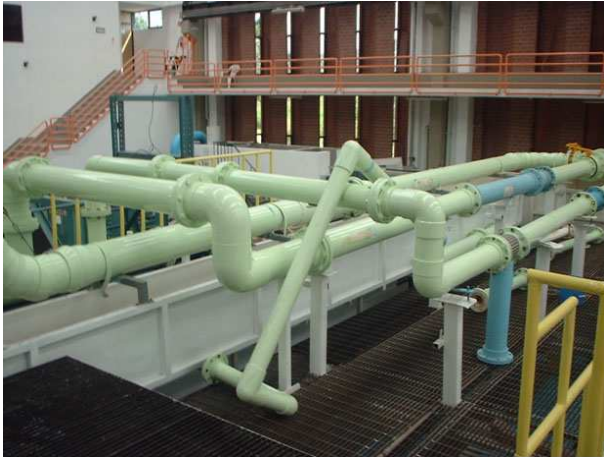
a) Tren de piezas especiales en donde se lleva a cabo la verificación de micromedidores
