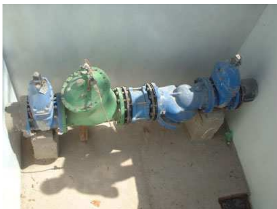
Foto No. 20 Muestra el tren de piezas especiales de la caja de control de presiones, el cual está formado de derecha a izquierda por: una válvula de compuerta, un filtro, una junta de alta tolerancia, una válvula reguladora de presión y finalmente por otra válvula de compuerta.
