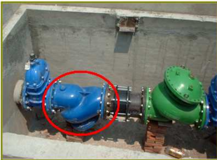
Figura 56.0.- Colador en línea colocado en el tren de piezas, aguas arriba de la VRP.
