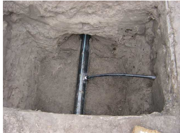
f) Rehabilitación de ramal para toma domiciliaria mediante el método de reventamiento
