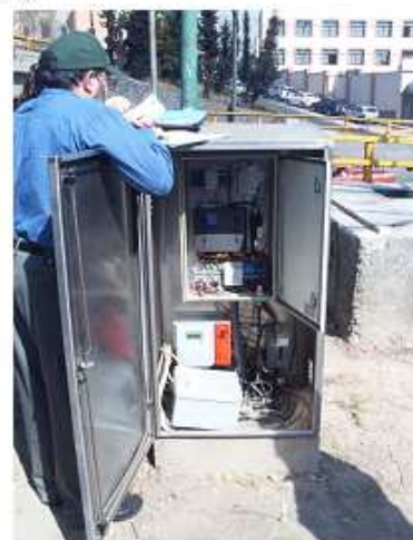
Figura 84.0.- Gabinete de acero inoxidable instalado
