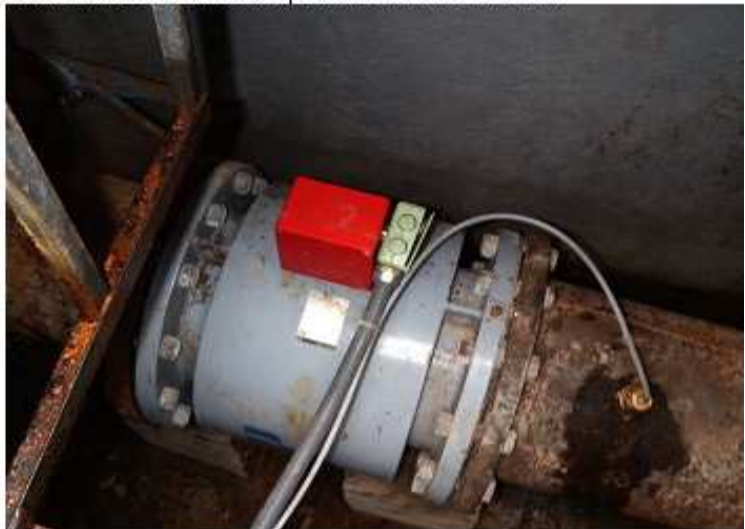
Figura 92.0.- Medidor de flujo electromagnético utilizado en la campaña de medición
