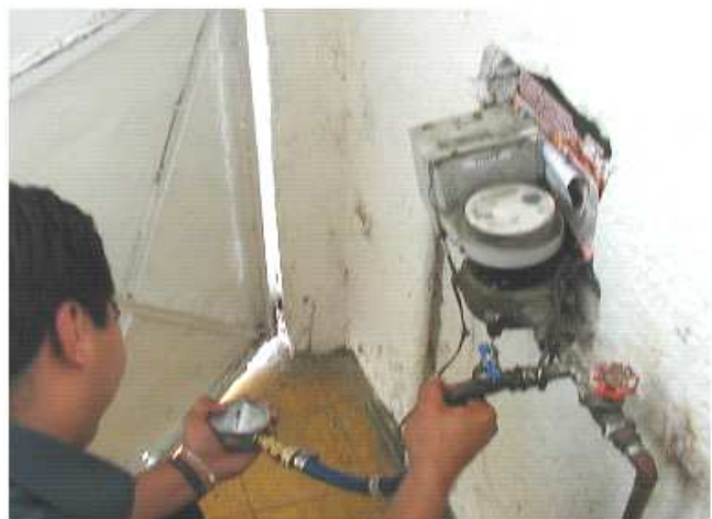
Figura 50.0.- Medición en toma domiciliaria
