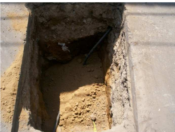
i) Se observa el relleno con tepetate de ventanas hechas sobre arroyo vehicular.
