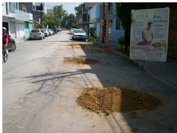
j) Se observan las ventanas hechas sobre el arroyo vehicular rellenas de tepetate.
