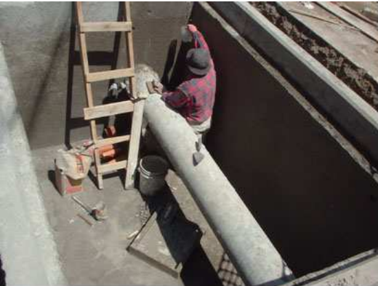
Foto No. 11 Muestra el acabado interior de la caja de medición de gasto y control de presiones, aun no se instala el tren de piezas especiales.
