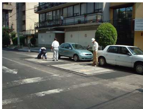
Foto No. 22 Muestra una vista general de las cajas de medición de gasto y control de presiones ya terminadas.
