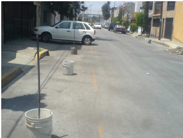
a) Trazo de ejes para el tendido de la red de tubería.
