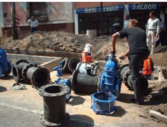
Foto No. 13 Muestra parte del equipo y piezas especiales listas para su instalación en el interior de la caja de medición.
