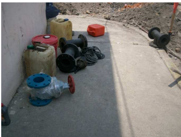
c) Se observan algunas piezas especiales de Fo. Fo. Que se utilizan para realizar seccionamientos
