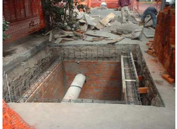
Foto No. 10 Muestra el acero de refuerzo, ya habilitado y colocado, correspondiente a la dala perimetral de la caja de medición.
