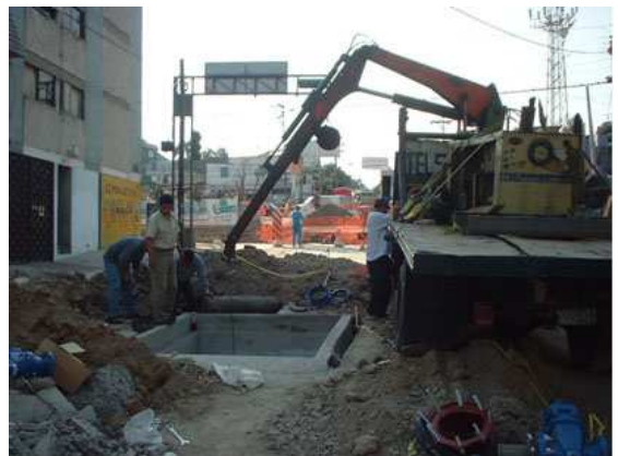
Foto No. 14 Muestra la utilización de una grúa, también se puede utilizar para sostener las piezas especiales a instalar, mientras el personal calificado realiza dichos trabajos.
