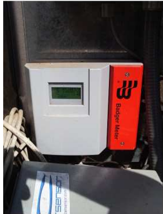
Figura 93.0.- Unidad de visualización electrónica para verificación de gasto instantáneo
