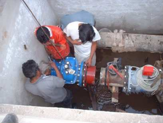
Foto No. 15 Muestra la Instalación del tren de piezas dentro de la caja de medición de gasto, obsérvese el medidor de flujo electromagnético.
