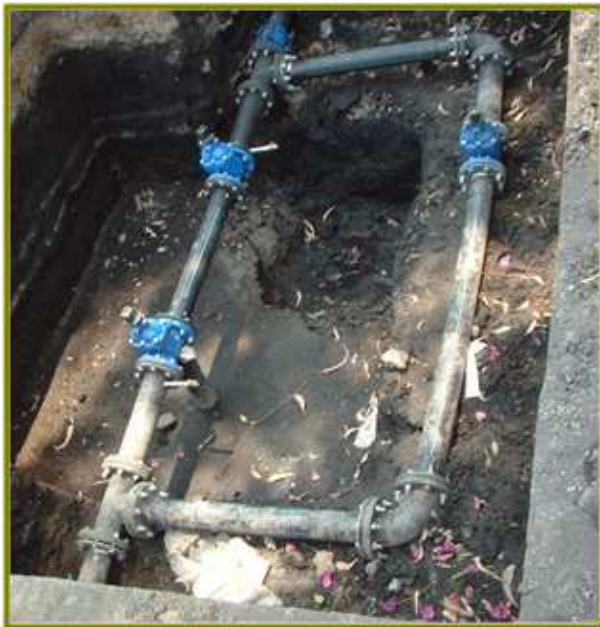
Figura 55.0.- Modificación de la red con válvulas de seccionamiento. Preparación para una caja de control.
