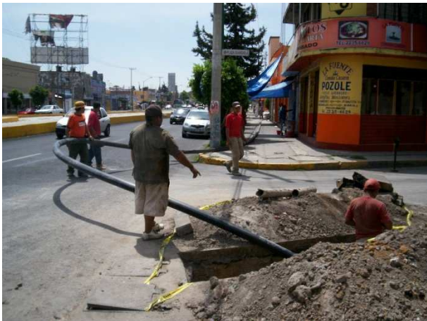
g) Sustitución de tubería por método de rompimiento e introdeslizamiento de tubería
