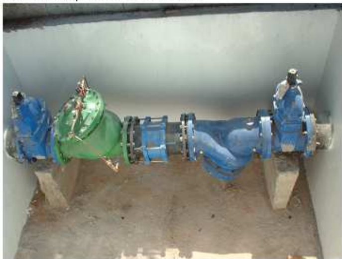
Figura 82.0.- Componentes de una estación de control de presión instalados
