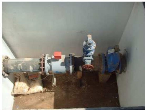
Foto No. 19 Muestra el tren de piezas especiales en el interior de la caja de medición de gasto, el cual está formado de derecha a izquierda por: una válvula de compuerta, una válvula de admisión y expulsión de aire y un medidor de flujo electromagnético.
