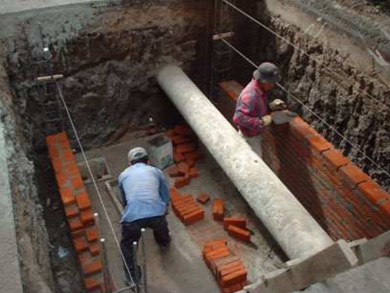
Foto No. 9 Muestra el levantamiento del muro perimetral de la caja de medición, se observa que los muros son de doble hilada de tabique.
