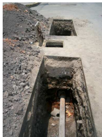
d) Se observa el estado en el que se encuentra la tubería existente de red secundaria de agua potable en este sitio.
