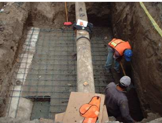
Foto No. 7 Muestra el habilitado del acero de refuerzo de la losa de piso de las cajas de medición de gasto y control de presiones.
