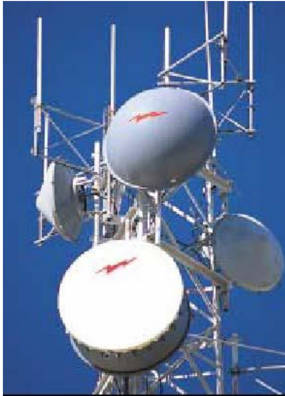
Fig. 1.9 Sistemas de radio donde la unidad de antena RF es montada al aire libre.
