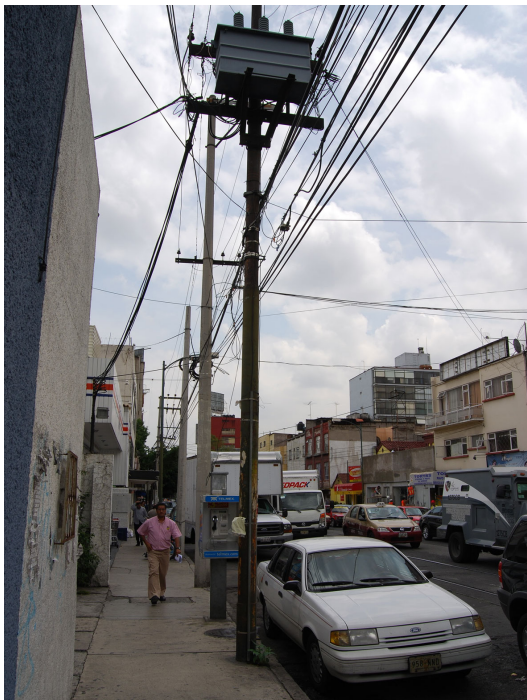
Gráfico No. 48 Desorden de los distintos tipos de cableado.
