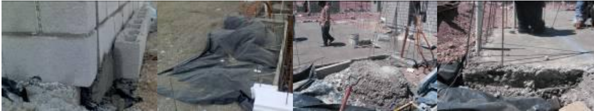
Figura II.15 Falta de calidad en cimentaciones
