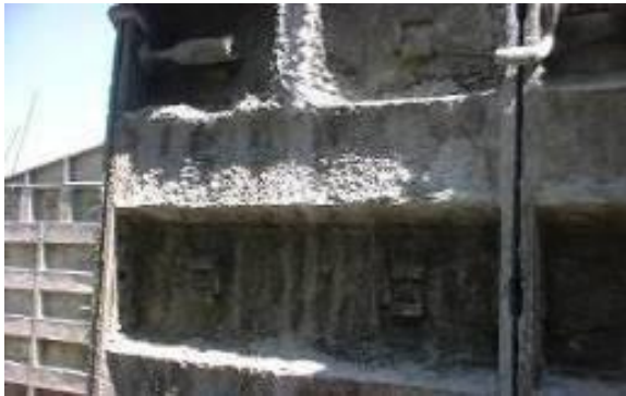
Fig. IV.37 Falta de limpieza diaria de la cimbra que la deteriora y deforma rápidamente
