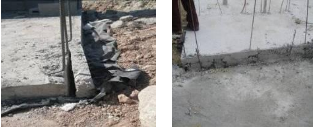
IV.29 Imagen de mala calidad en cimentaciones que afecta la colocación del molde
