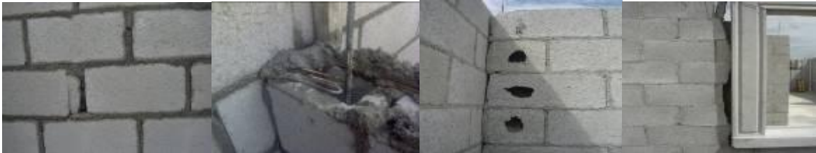
Figura II.17 Falta de calidad en muros de block
