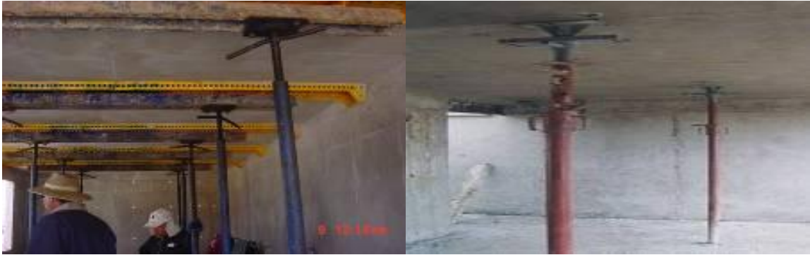
IV.38 Fisuras en la losas por apuntalamientos deficientes (incumplimiento del tiempo especificado)
