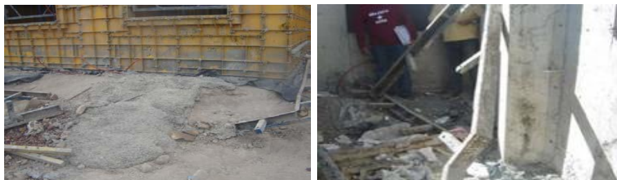
Fig. IV.34 Accesorios mal utilizados
