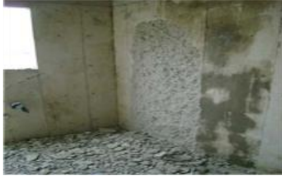
Fig. IV.35 Rebajes en muros botados, causa: no se colocaron todos los candados para formaleta o no hubo una revisión previa al colado.
