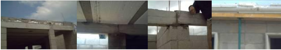
Figura II.19 Falta de calidad en losas de entrepiso
