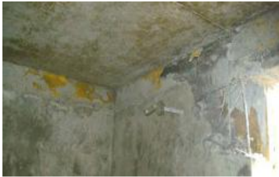
Fig. IV.36 Oquedades por no contar con un buen equipo de vibración.
