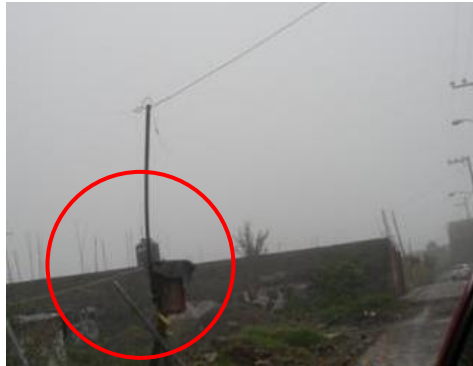
Figura 4.8 Riesgo por descarga eléctrica
