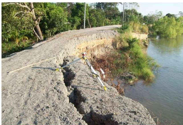
Figura 4.15 Erosión fluvial (Auvinet et. al. , 2008)
