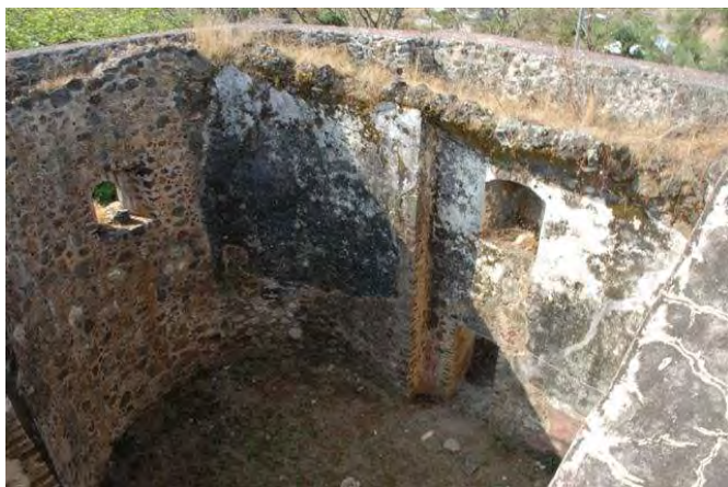
Figura 26. Tramo del presbiterio del templo de la Asunción Ahuatlán, el cual perdió la bóveda, quizá debido a un error de cálculo.
