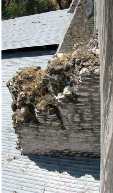
Izquierda. Figura 25. Restos de uno de los contrafuertes adosados a la fachada oriente de la capilla de San Miguel Anenecuilco.
