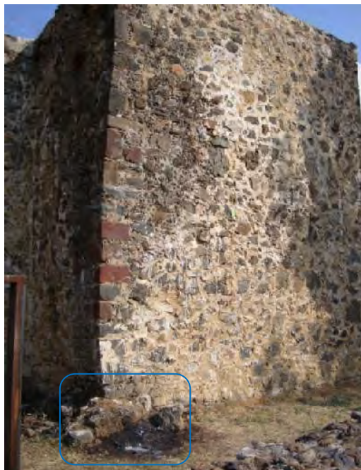
Figura 16. Esquina sureste del muro testero de la capilla, la que tuvo movimientos diferenciales por falta de compactación de los rellenos de la plataforma.
