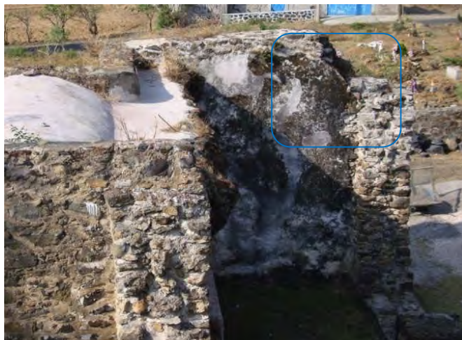
Figura 17. Desgajamiento del paramento sur de la nave longitudinal de la capilla abierta de Ahuatlán.
