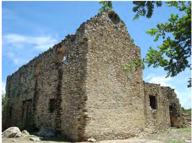
Figura 26. Vista noreste de las dependencias de la plana alta de Las Bóvedas.
