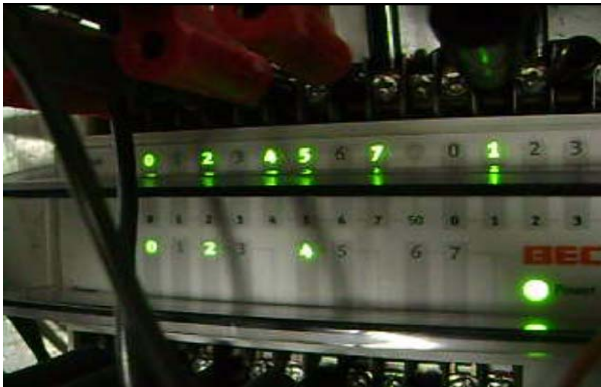
Figura B13. Detalle de accionamiento de entradas/salidas del PLC.
