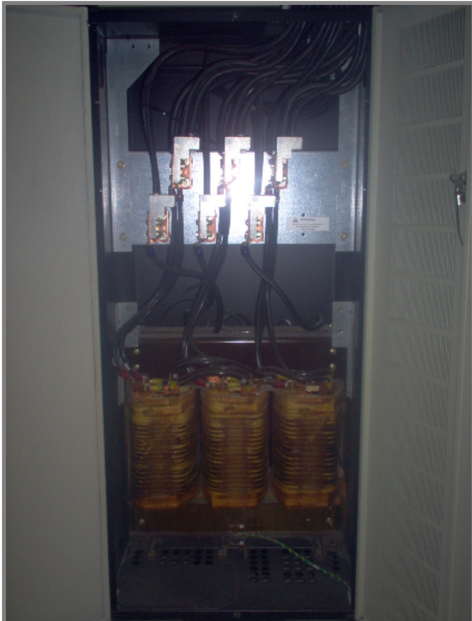
Figura 8.7 Primer transformador elevador de tensión 220Y/127 - 480Y/277 VCA, 60 Hz al primer SAI, ver figura 8.4.
