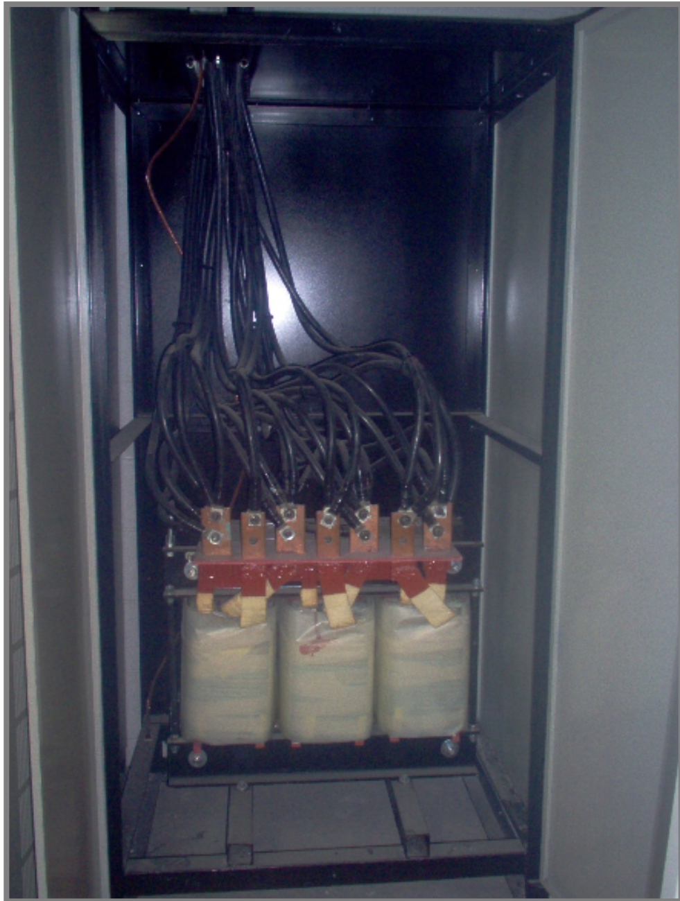
Figura 8.8 Segundo transformador elevador de tensión 220Y/127 - 480Y/277 VCA, 60 Hz que alimenta al segundo SAI, ver figura 8.4.
