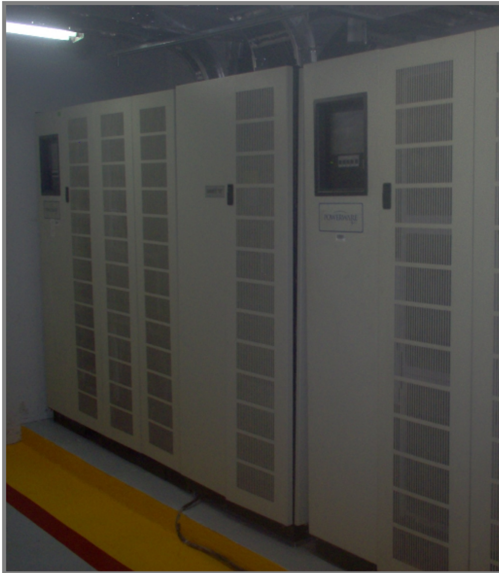
Figura 8.9 Dos SAIs de gran capacidad, por ejemplo de 225kVA cada uno en paralelo redundante 480Y/277 VCA, salida 208Y/120, 60Hz, ver figura 8.4.
