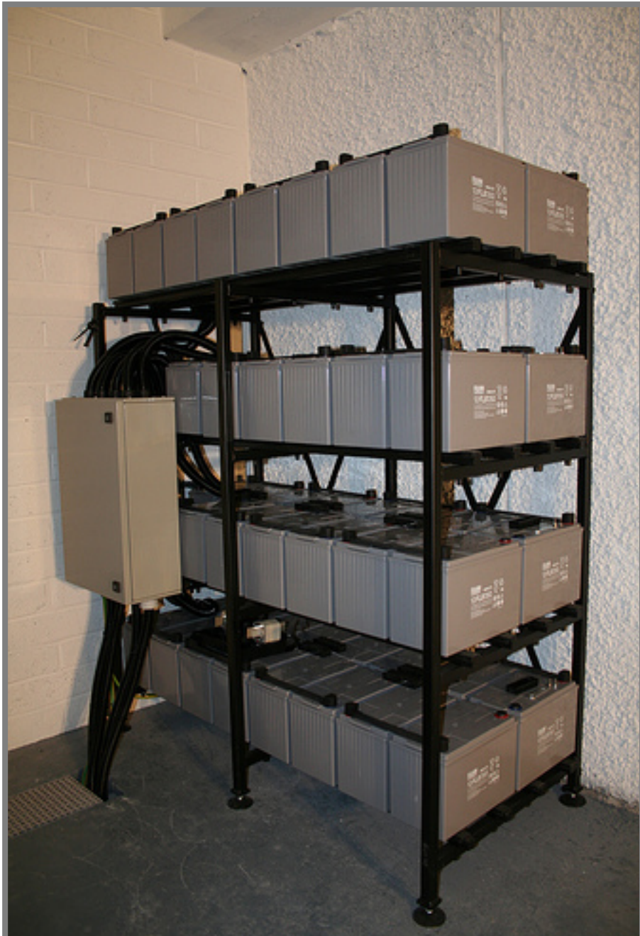
Figura 8.12 Banco de baterías, dos string de 30 baterías cada uno, 400 Vcd aproximadamente, para un respaldo de 10 minutos, ver figura 8.1 a 8.4.
