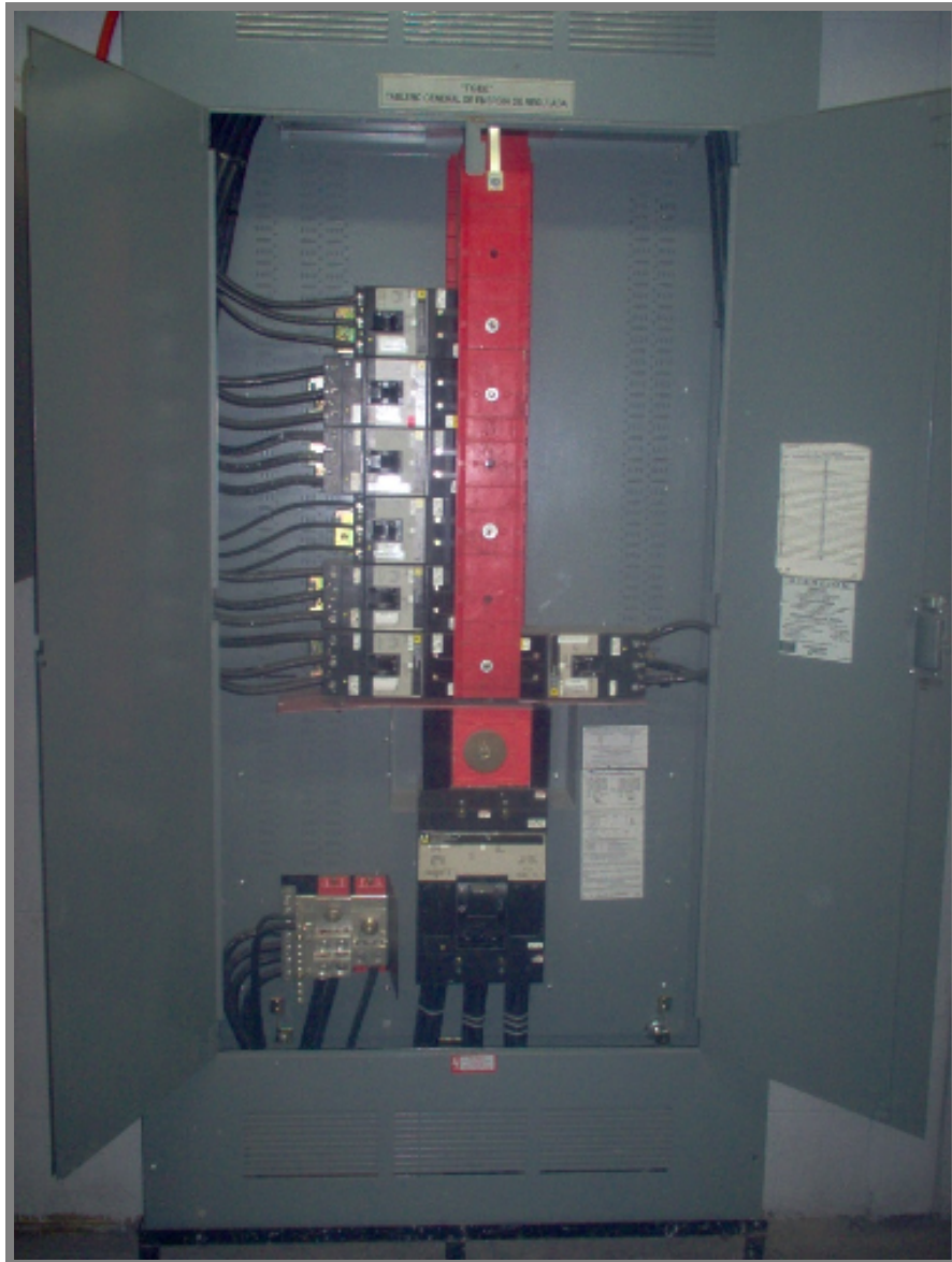
Figura 8.10 Tablero de salida regulado, los cuales alimentan a otros subtableros eléctricos, ver figura 8.1 a la 8.4.
