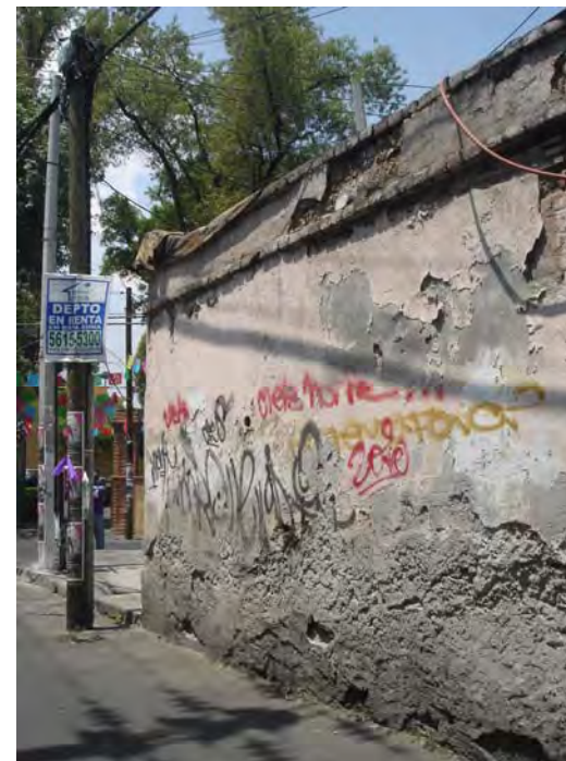
34. Calle San Felipe, barda de adobe que por falta de mantenimiento se encuentra muy deteriorada. No hay banquetas, lo que denota la antigüedad del predio, anterior a la introducción de automóviles
