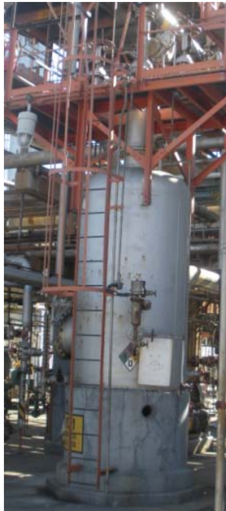
Figura 46. Fotografía del Separador 11C1 en la Planta U11
