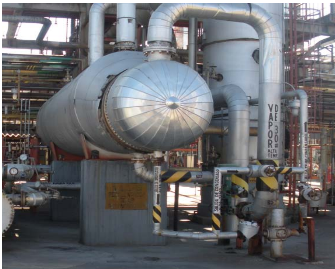
Figura 49. Fotografía del Rehervidor 11E5 Tren Poniente en la Planta U11
