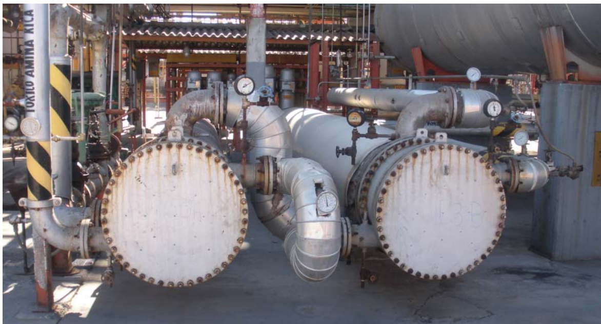
Figura 48. Fotografía de los intercambiadores 11E3AB Tren Poniente en la Planta U11
