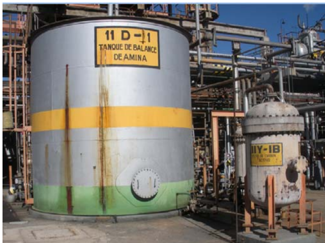
Figura 51. Fotografía del tanque de amina para ambos trenes en la Planta U11
