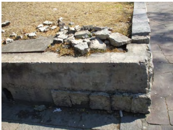
Figura 3 Deterioro de infraestructura urbana
