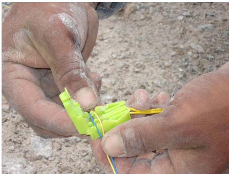
Figura 25. Conexión del iniciador Unitronic al cable eléctrico línea troncal. (Detalle)
