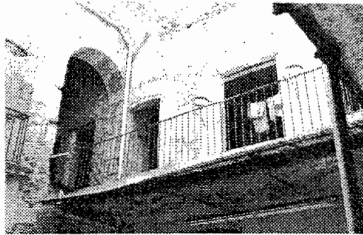
29. Vista hacia la planta noble del segundo patio - Esguimientos - Desprendimiento de aplanados por falta de un pretil en la azotea - Sobre el muro del lado izquierdo muestra un balcón y el vano tapiado de una puerta que está en el cubo de las escaleras
