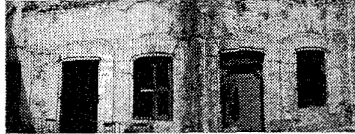
41. Segundo patio, vista norte Muros desprovistos de aplanado, intemperizados con grietas Vegetales parásitos en muros y pisos Vanos sin carpintería o en malas condiciones Desprendimiento de marcos de cantera en el repisón de las ventanas Escalera marina con piezas faltantes y oxidadas Falta el barandal de este lado
