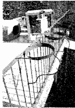
31. Balcón de hierro forjado con maceteros - Oxidado por falta de mantenimiento
