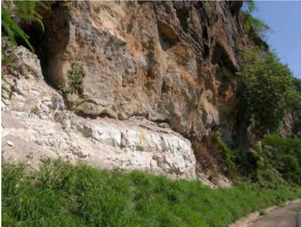
Fotografía V.1 Vista de sur a norte, en donde se puede observar la calidad de la unidad U1, así como la erosión y alteración provocada por el escurrimiento e infiltración de agua.
