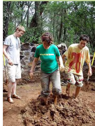
El Bosque-Village: Ecoaldeas ecoturística ubicada en el bosque Purépecha de Michoacán. México. En la foto, turistas preparan la mezcla para construir con tierra.
