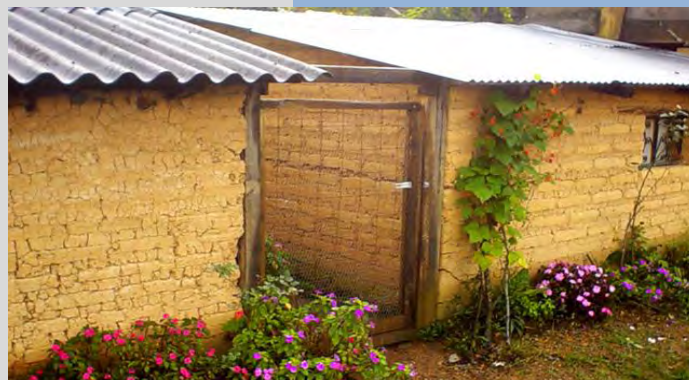
Patrón 1. Variación 1.2. Techo a dos aguas: Lámina . Esta vivienda tiene todas sus techumbres construidas a base de lámina de asbesto sin amarres hacia el bastidor. Vivienda en SIR. ALJ
