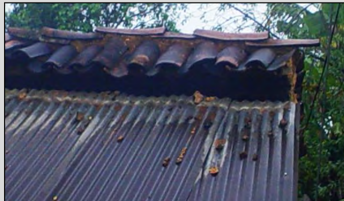
Patrón 1. Variación 1.3. Techumbre en mal estado. Originalmente había sido construida con Lámina-Teja; actualmente solo conserva algunas de sus tejas, incluyendo las del cuerpo contiguo. SIR ALJ
