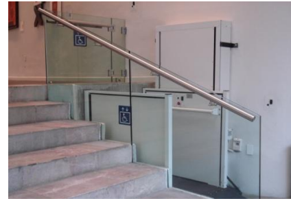
Lift como alternativa a la escalera en el C. Cultural Bella Época.
