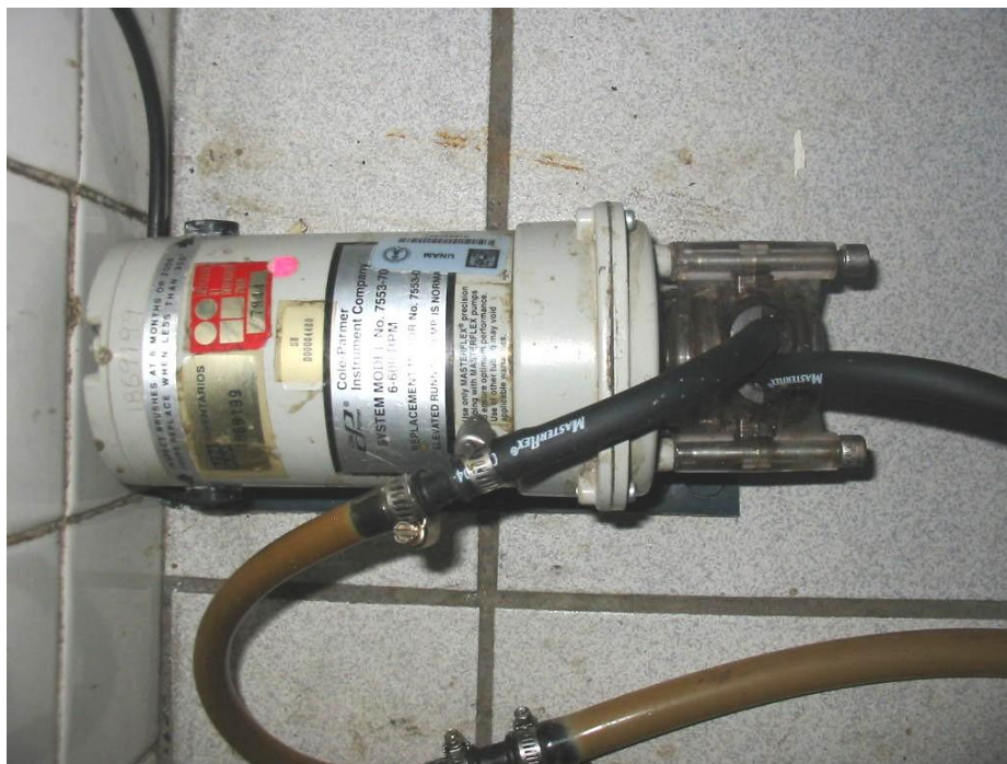
Figura 4.4. Arreglo de bomba peristáltica y motor para recirculación de los lodos utilizado (dos unidades).
