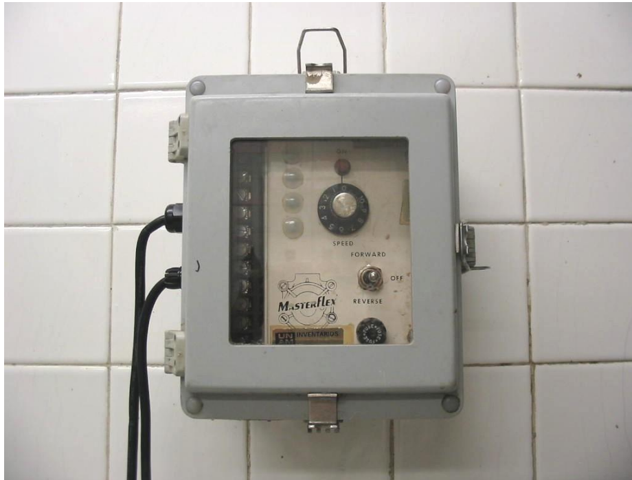
Figura 4.3. Controlador de velocidad de la bomba para la recirculación de lodos utilizado (dos unidades)
