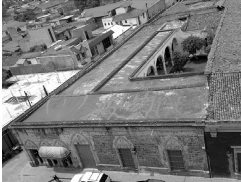
FIG.III.132 Vista desde la azotea del templo de santa María del Pópulo de la fachada con ornamentaciones góticas y el patio neoclásico. La cubierta original de la casa, ha sido sustituida por losas de concreto, también se retiró la teja. Foto JGGB.
