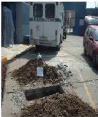
3. HUECO EN PAVIMENTO DE CONCRETO EN LA CALLE DE LA FERIA, EN EL PASEO DE LA FERIA, EN EL MUNICIPIO DE ARAGÓN, ESTADO DE MÉXICO.
