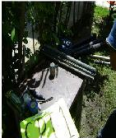
ENTUBACION DE LA OBTURACION DE LOS CABLES EN EL PASILLO
