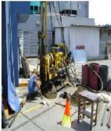
EXCAVADOR EN EL SITIO DE TRABAJO CON MATERIALES Y EQUIPO DISPUESTOS AL ALREDEDOR.
