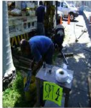
TRABAJO DE REPARACIÓN DE LA PARED DE CONCRETO Y REFORZAMIENTO DE LOS CIMENTOS DE LA SPT 4.
