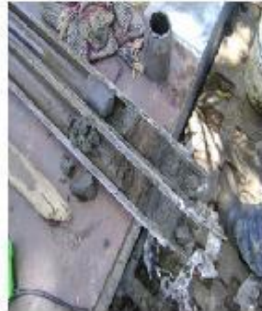
DAÑO EN EL TUBO DE VENTILACION DEL TUBO DE LA CUBIERTA
