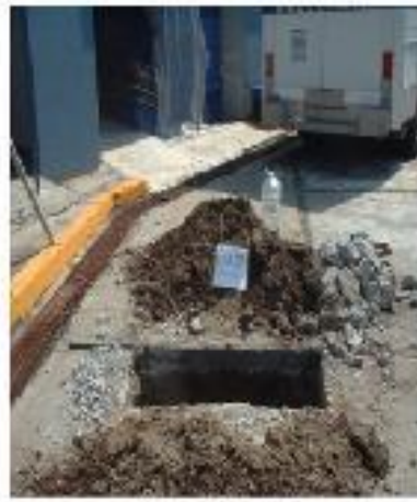
2. HUECO EN PAVIMENTO DE CONCRETO EN LA CALLE DE LA FERIA, EN EL PASEO DE LA FERIA, EN EL MUNICIPIO DE ARAGÓN, ESTADO DE MÉXICO.
