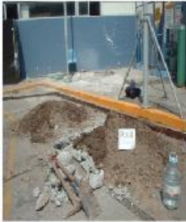
1. HUECO EN PAVIMENTO DE CONCRETO EN LA CALLE DE LA FERIA, EN EL PASEO DE LA FERIA, EN EL MUNICIPIO DE ARAGÓN, ESTADO DE MÉXICO.
