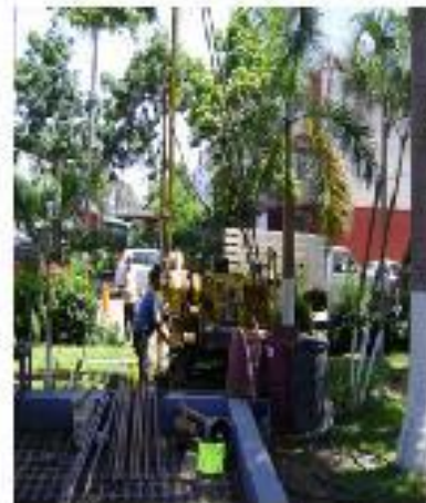
CONSTRUCCIÓN DE TUBO PARA EL PASADIZO DE LA CALLE DE LA PLAZA DEL VIAL 13
