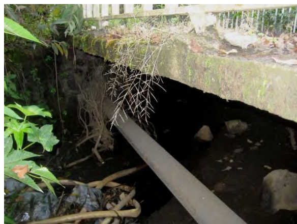
Imagen 3.7. Tubería de acero bajo puente.
