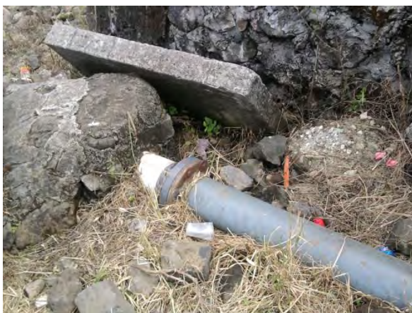
Imagen 3.14 Unión en mal estado.
