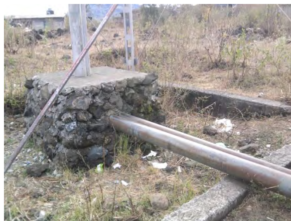
Imagen 3.15 Llegada de tubería a tanque.
