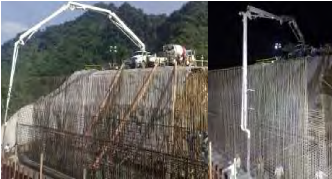
FIGURA 15 EQUIPO PARA CONCRETO BOMBEABLE
