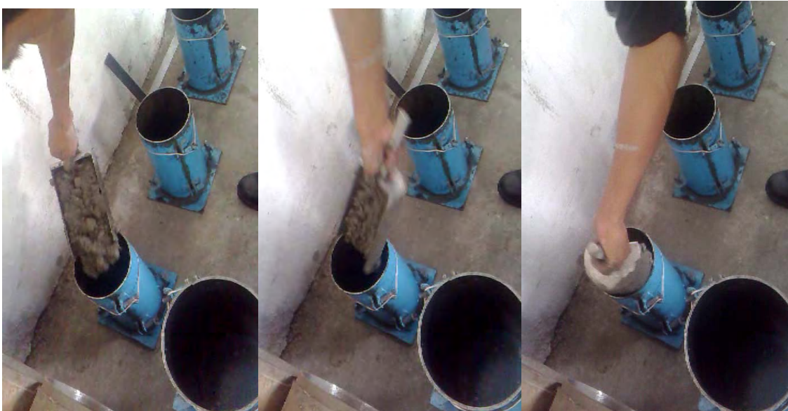
FIGURA 39 PROCEDIMIENTO DE VACIADO EN CILINDROS
