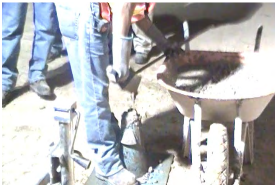
FIGURA 28 EXCEDENTE DE CONCRETO PARA GARANTIZAR EL NIVEL
