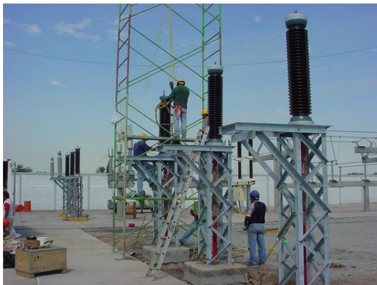
Foto 33. Terminales en subestación
