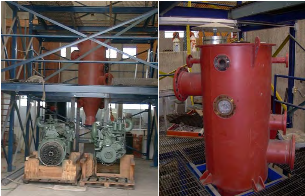
Figura 2.2. Vista frontal de la planta y gasificador de biomasa de la planta del Instituto de Ingeniería de la UNAM
