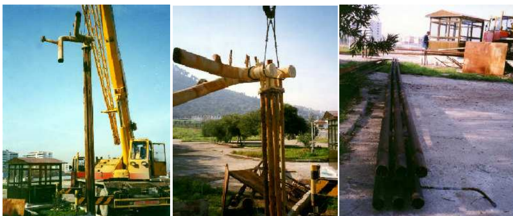
Figura 2.21 Intercambiadores de calor de fondo de pozo en Balçova
