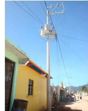
6.-Servicio de energía eléctrica.
