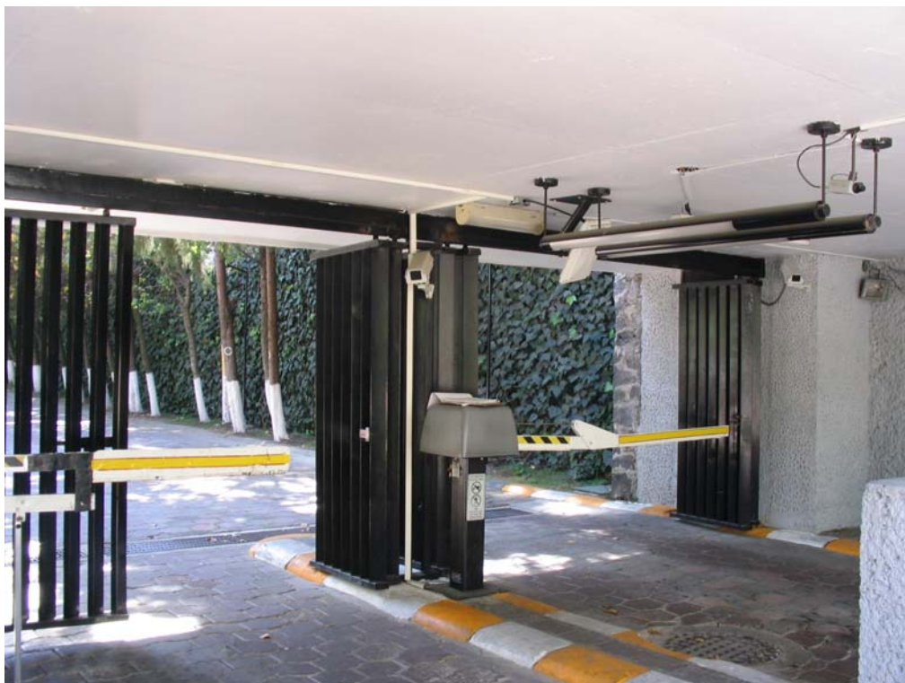
Fig. 6 Dispositivos de seguridad y control en el acceso
