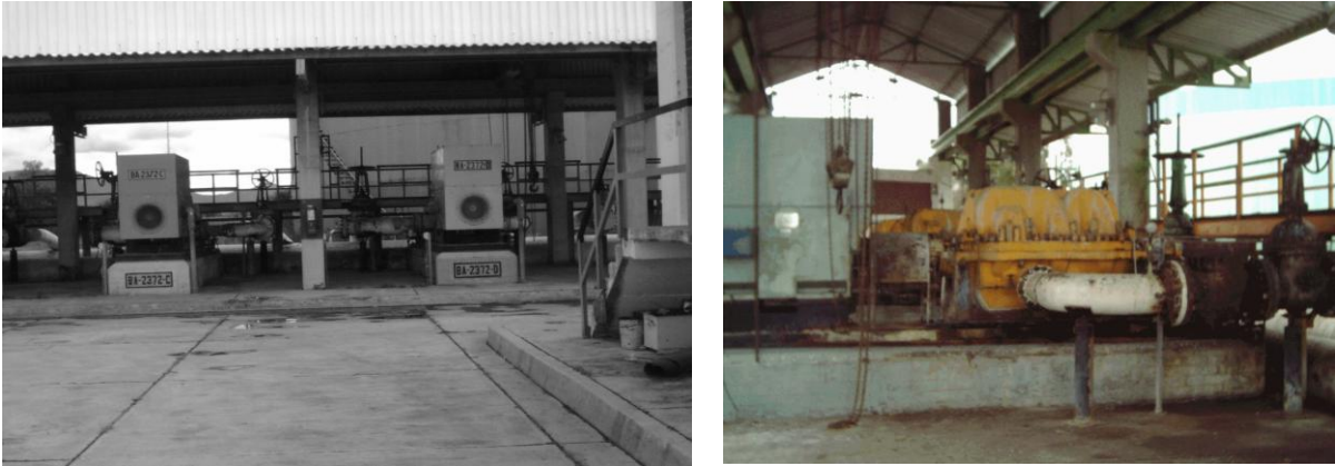
Fotografías del equipo de bombeo de la estación Mangas.
