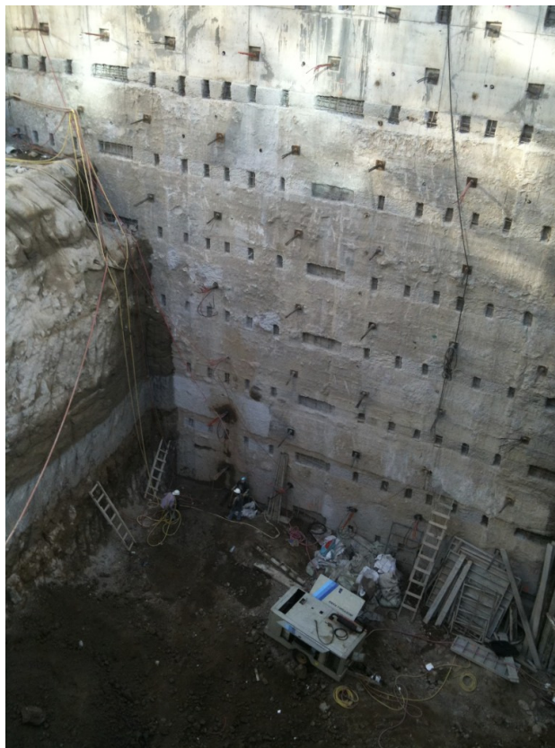
Vista General del Muro Milán con anclas durante el proceso de excavación
