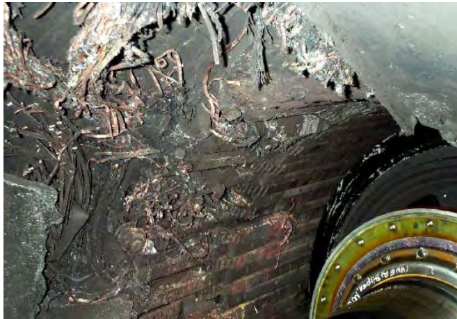
Figura 3.14 Embobinado de estator quemado por fallo de fase.
