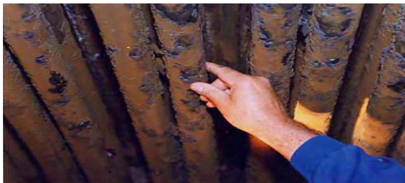
Figura 5.5 Corrosión de fluses o tubos que impiden la eficiente transmisión de calor.
