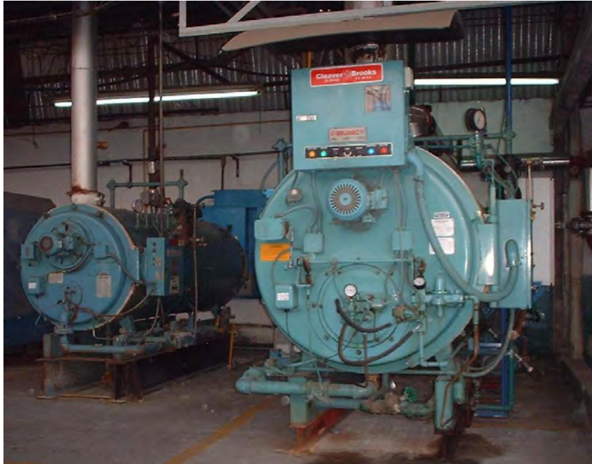
Figura 1.4 Calentamiento de químicos por medio de calderas de vapor.
