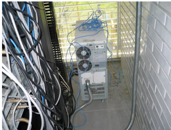
Fig. 5.14 Imagen representativa del estado actual de un UPS del Centro de Cómputo del CCH Vallejo.
