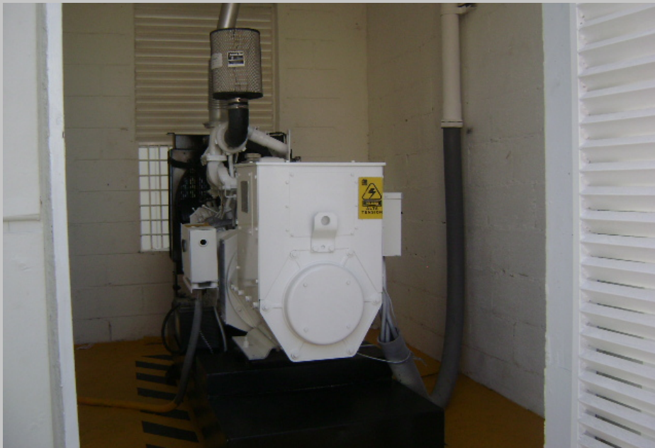
Planta de Emergencia de 80 kW en la Tienda Mini Elektra Kukulkan
