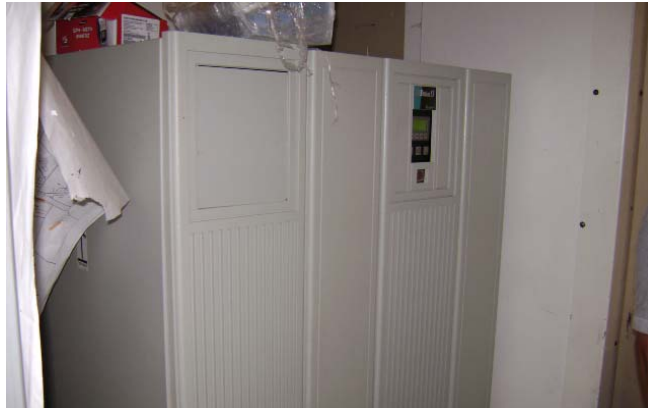
Fig. 5.12 Imagen representativa de un UPS de capacidad alta, UPS instalado en una Tienda Elektra de la ciudad de Mérida.
