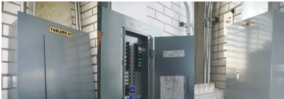
Fig. 4.12 Tablero "B" A-1 de 42 circuitos y derivados R3 y R4.
