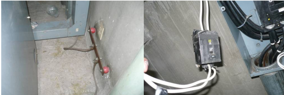
Fig. 5.13 Imagen del estado actual del área del Transformador en el Centro de Cómputo del CCH Vallejo.
