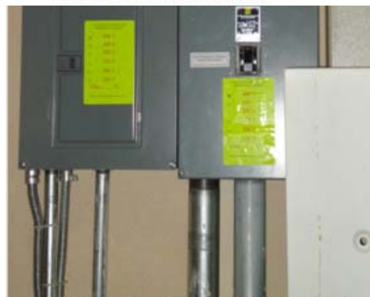
FIG-29 DEBIDO A LA GRAN CANTIDAD DE EQUIPO QUE UTILIZA LA RESONANCIA MAGNETICA, LAS INSTALACIONES SON MUCHAS Y MUY CARAS
