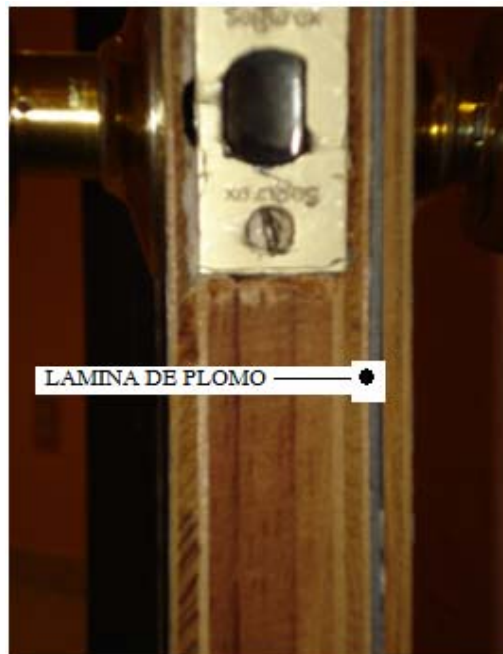
FIG- 22 SE PUEDE OBSERVAR LA LAMINA DE PLOMO COMO PROTECCION CONTRA LAS RADIACIONES, EN LA PUERTA DE ZONA DE CONTROLES.
