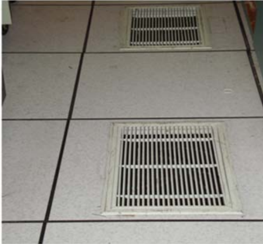
FIG- 25 EL USO DE ESTE EQUIPO GENERA MUCHO CALOR POR LO QUE SE REQUIERE UNA VENTILACION ESPECIAL ACONDICIONADA, COMO ESTA, POR PISO.
