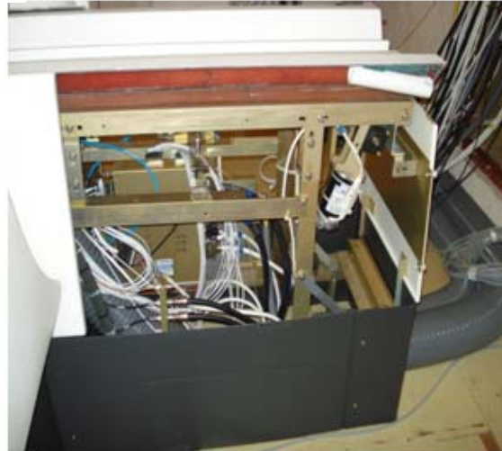
FIG- 30 INSTALACION ELECTRICA DE LA RESONANCIA MAGNETICA
