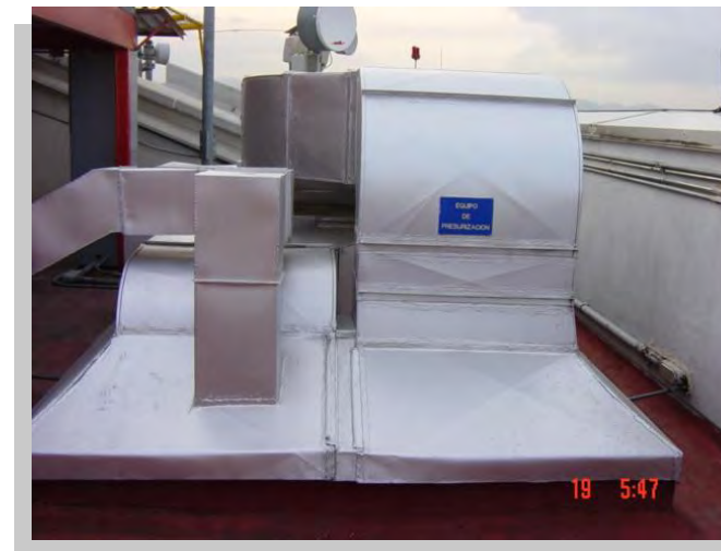
Sistema de Presurización
