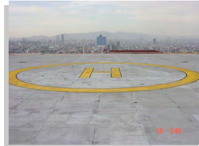
Plataforma de Helipuerto
