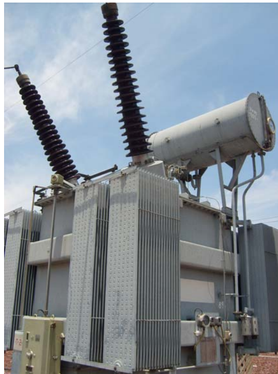
Figura 1.2.29: Transformador de tracción de Subestación Eléctrica Tultitlán. fuente: foto tomada por Marcos Peña para este trabajo.
