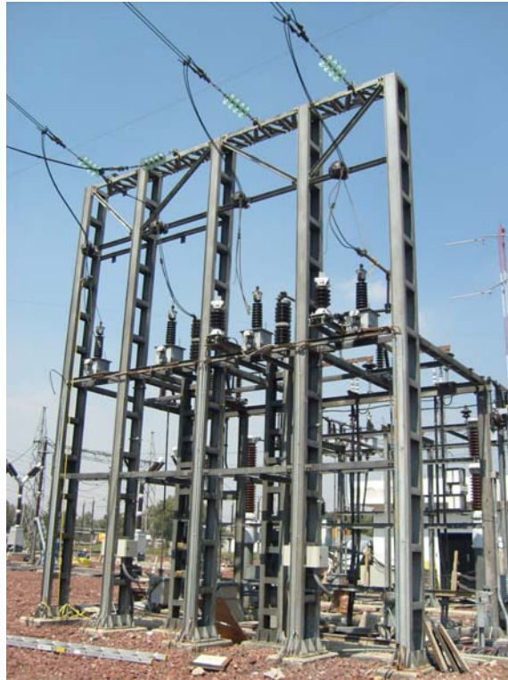
Figura 1.2.32 1.0 : Portal de feeders a catenaria. Fuente: foto tomada por Marcos Peña para este trabajo.
