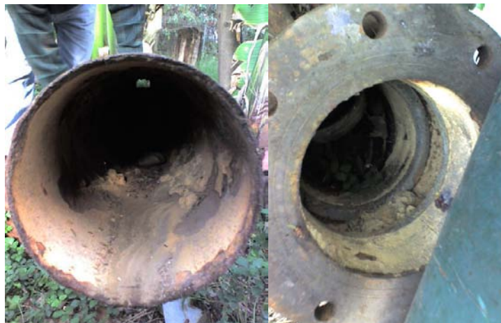
Figura 27. Incrustaciones en las tuberías de agua potable
