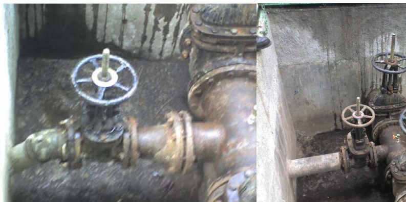
Figura 30. Reducción de diámetros en la red. Izquierda: Reducción campana. Derecha: Tee reductora.
