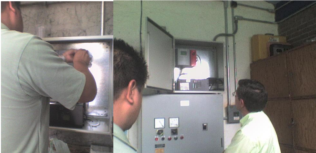
Figura 21. Medidor Electromagnético en Tanque Bajo Lado Norte y Sur, respectivamente.
