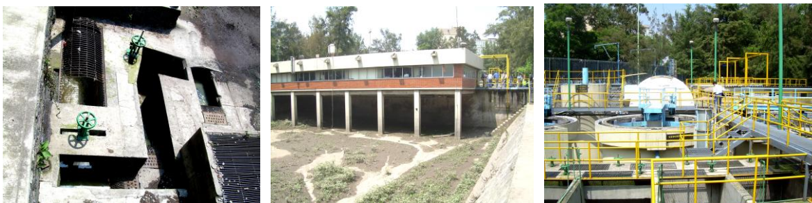
Figura 3. Planta de tratamiento de aguas residuales Cerro del Agua
