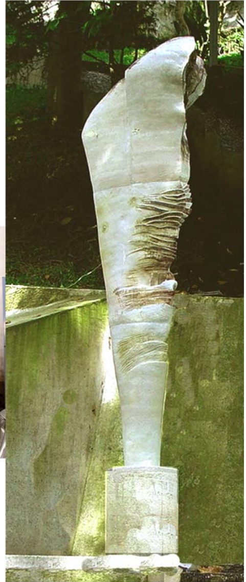
Proceso construcción y montaje escultura INFLORECENCIA 4 metros de altura PLAZA XALITIC, XALAPA, VER.
