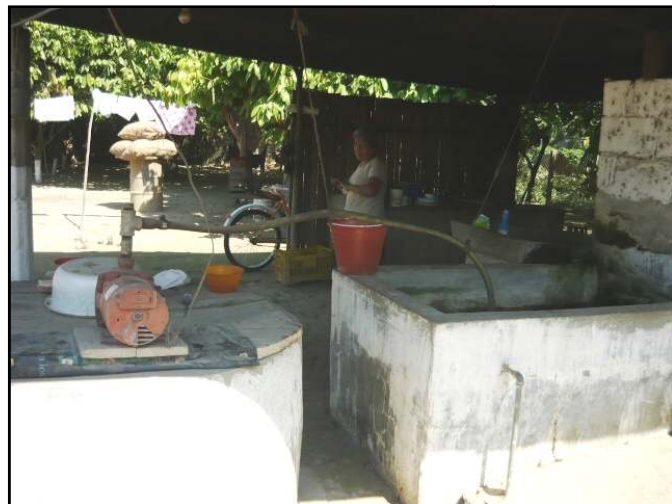
Foto 2. Bomba de succión conectada a un pozo de agua.
