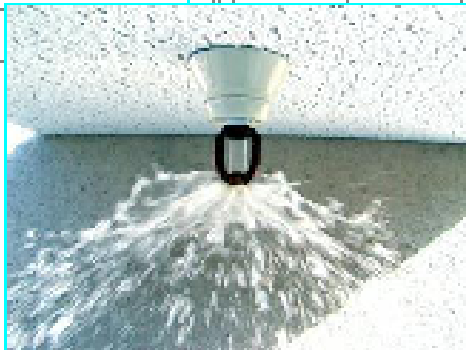
SPRINKLER BAJO PLAFOND
