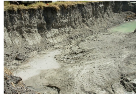
FOTO TERRENO C Y D: VISTA NORTE A SUR, MAQ. EXCAVACIÓN EXISTENTE Y EXCAVACIÓN MISMA (VÉASE PLANO TOPOGRÁFICO)
