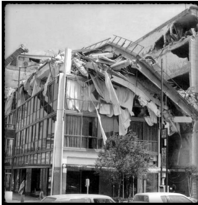
Figura 3.6. Falla por torsión en una estructura de esquina en la ciudad de México debido a los sismos de 1985
