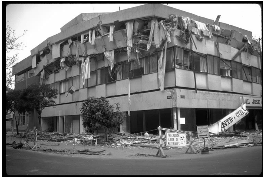
Figura 3.5. Falla por torsión durante el sismo de 1985 en México
