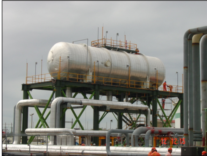
Fig.5.7.-Tanque de expansión térmica.
