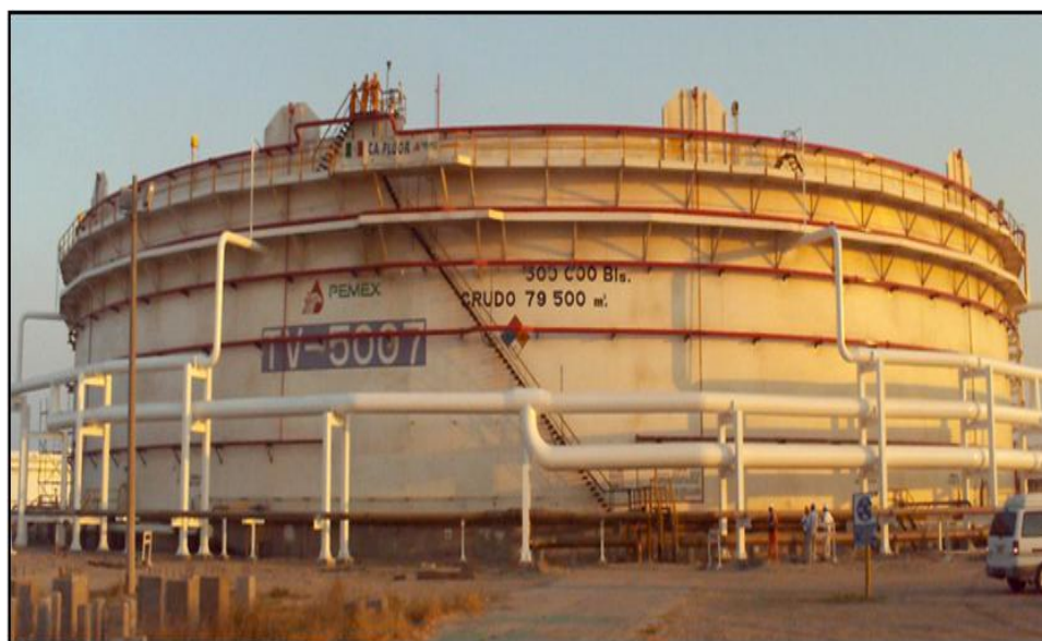
Fig.4.4.-Tanque de almacenamiento convertido a “Gun Barrel”.
