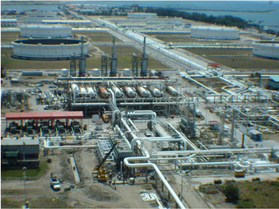
Fig. 3.2.- Área de Proceso Terminal Marítima Dos Bocas.
