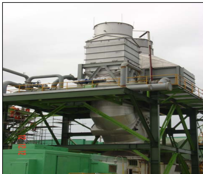
Fig.5.3.-Recuperador de calor B.
