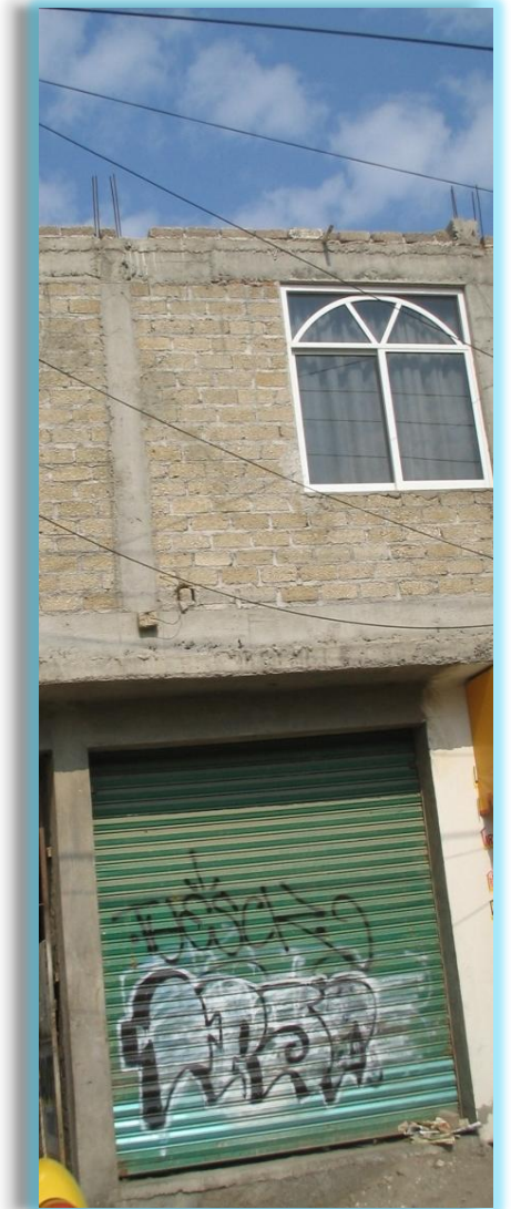
Ilustración 25 Falta de mantenimiento
