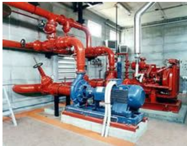
Figura 2.1. Bomba contra incendios.
