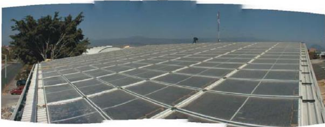
Campo de captadores solares de una instalación de refrigeración solar. Guetermann-Polygal – Cuernavaca - México
