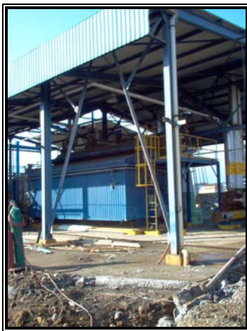
Figura 4.1. Instalaciones por dismantelar.
