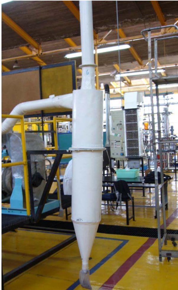
Fig. (22) Imagen del Separador Ciclónico instalado en el Secador Rotatorio del L.I.Q.
