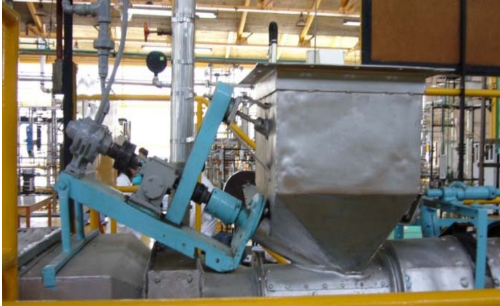
Fig. (23) Imagen de la Tolva instalada en el Secador Rotatorio del L.I.Q.
