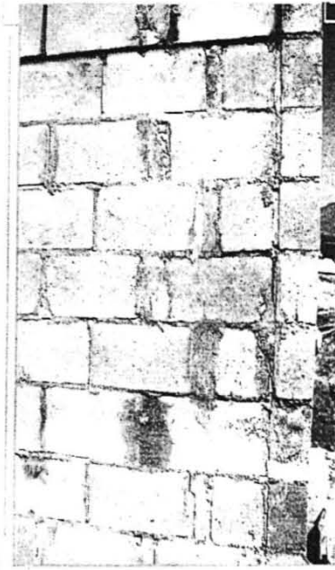
Pegado de bloque, deplomado, desalineado, y desnivelado
