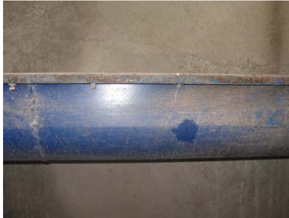
Transportador helicoidal (Elevador cangilones – Bodegas de almacenamiento)
