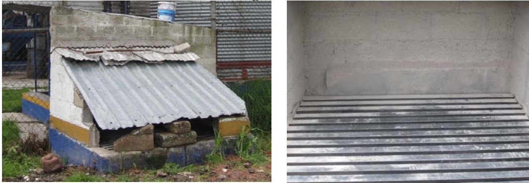
Tolva receptora con piso de rejilla
