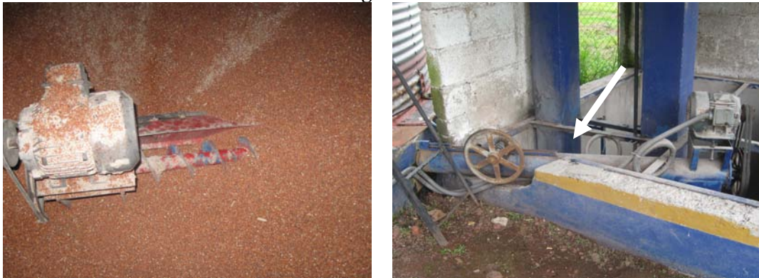
Transportador helicoidal (Silo recepción granos – Fosa receptora)
