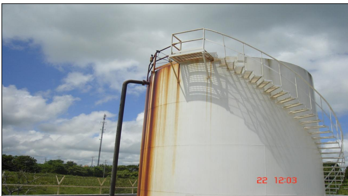
Figura 4.5. Tanque de almacenamiento dañado por la prolongada exposición al venteo de hidrocarburos.(PEP, 2008)
