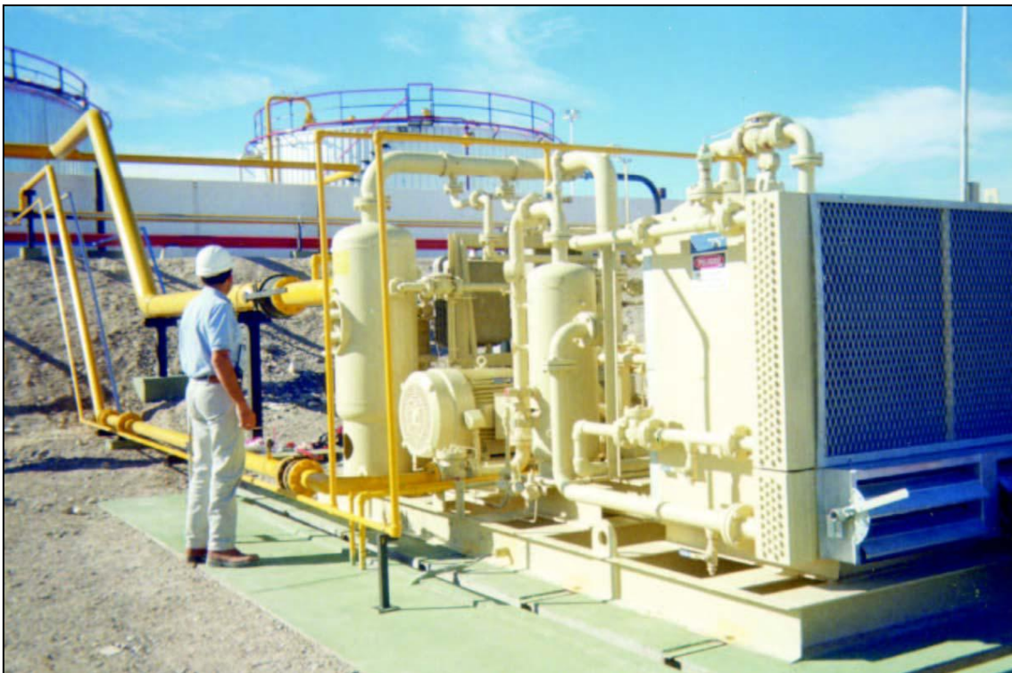
Figura 3.5. Unidad Recuperadora de Vapor instalada en el campo. (Taller de Transferencia de Tecnología PEMEX y Agencia de Protección Ambiental, EUA 25 de abril de 2006 Villahermosa, México)
